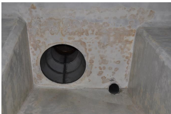
Figure 23 : Exemple typique de formation de taches dans une chambre à eau
