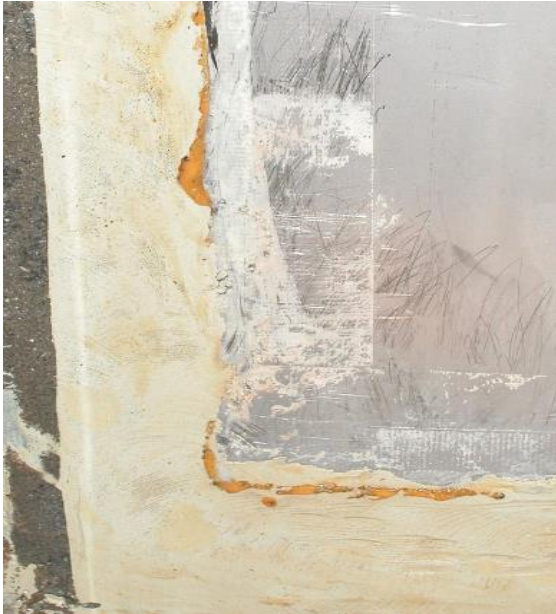
Figure 21 biofilm sur étanchéité époxydique
