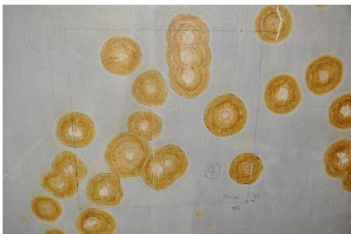
Figure 25 : endroit endommagé documenté
