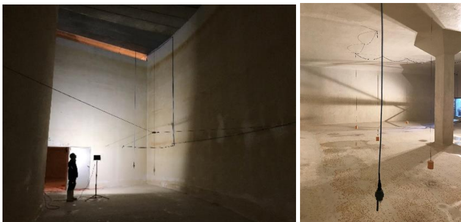
Figure 27 : Système de protection cathodique dans une chambre à eau vide
