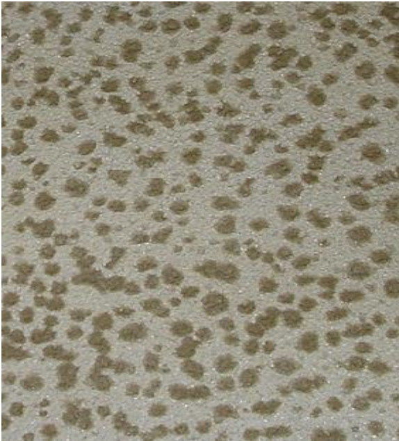
Abbildung 19 Fleckige Verwitterungen durch nicht fachgerecht aufgebrachte Beschichtung
