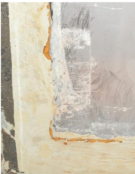
Abbildung 21 Biofilmbildung auf epoxidbasierter Abdichtung
