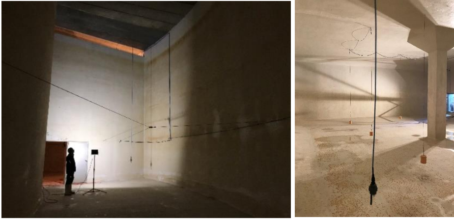
Abbildung 27 Kathodische Schutzanlage in einer leeren Wasserkammer
