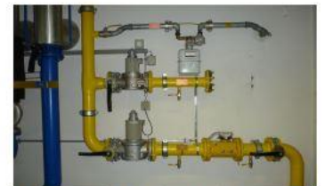
1 Installation de conduites de gaz naturel apparentes
