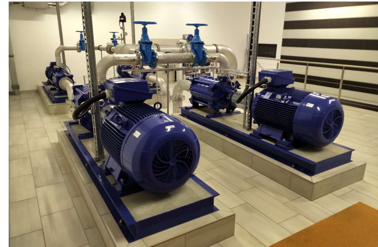
Pompes de refoulement au réservoir des Philosophes
