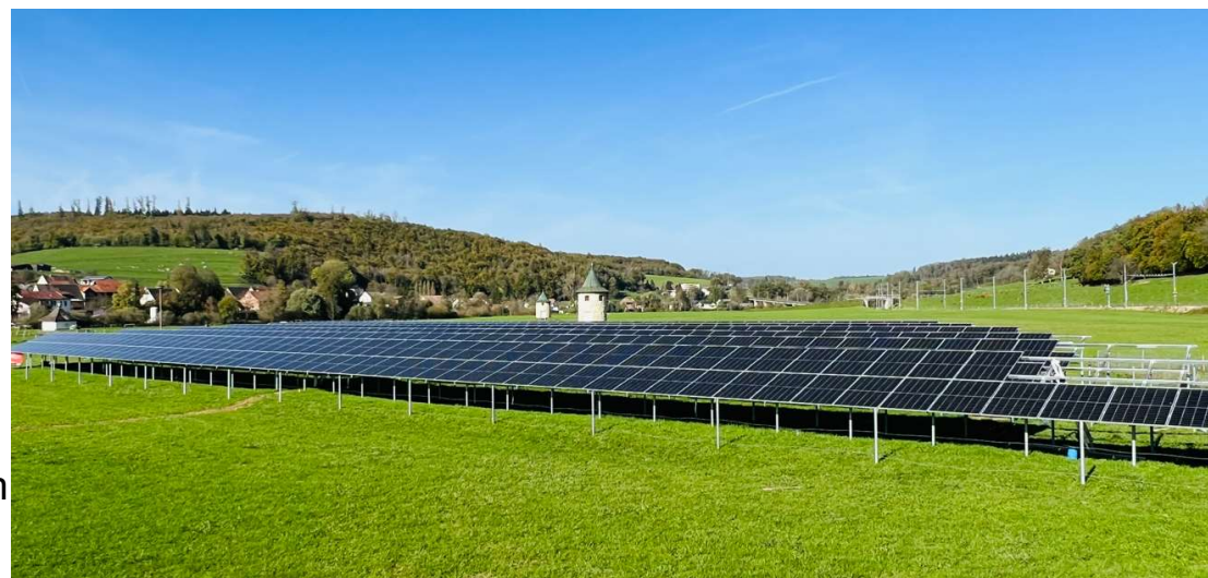
Vue générale de l'installation
