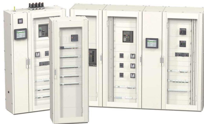
Cellule installée pour les départs d'alimentations des onduleurs
