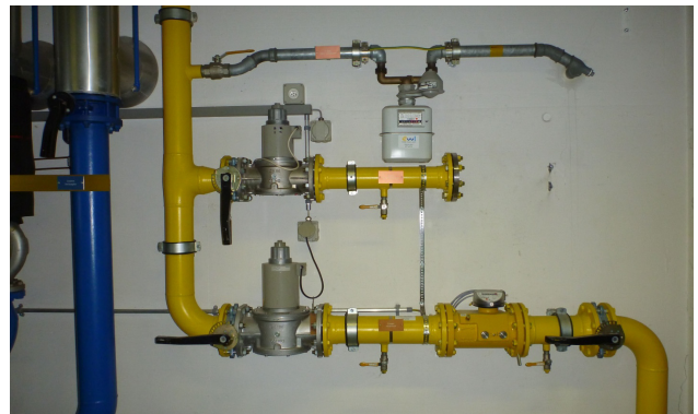
1 Installation de conduites de gaz naturel apparentes
