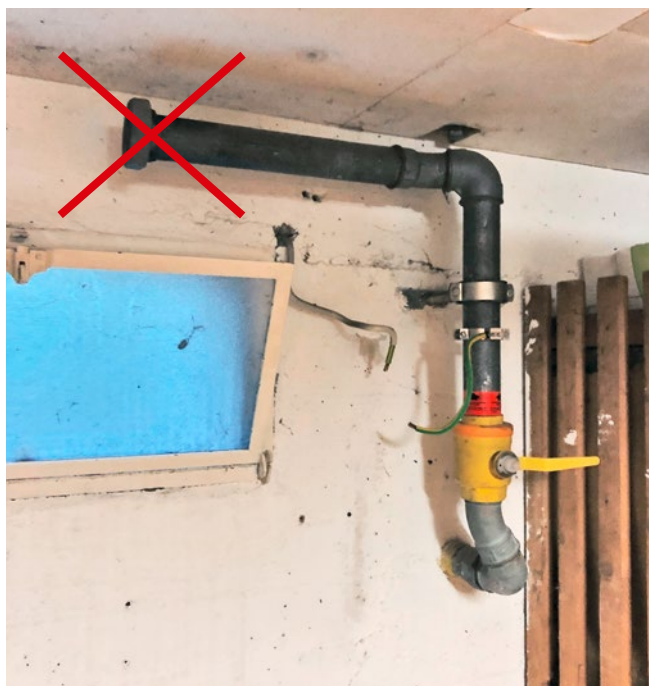
[ABB. 3] Unsachgemäss hinterlassener Gasanschluss. Stopfen fehlt.
