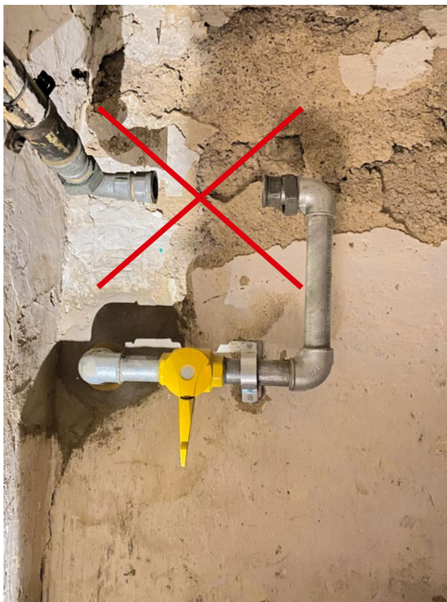
[ABB. 1] Nicht korrekt ausgeführter Rückbau. Stopfen fehlen.
